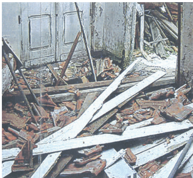
Figura 20 - Cobertura e forro desabados
