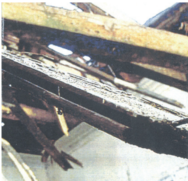
Figura 19 - Cobertura em ruínas
