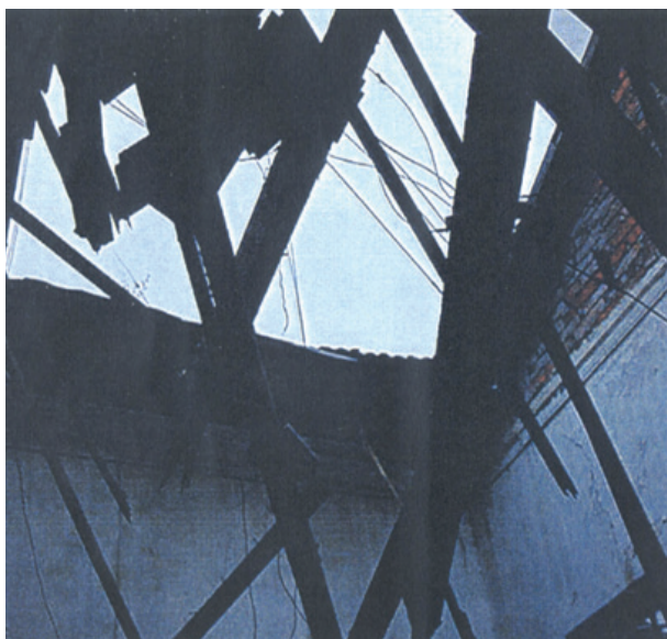
Figura 12 - Cobertura em ruínas
